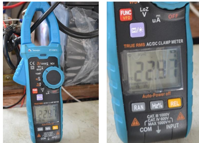
Figura 32 – MEDIÇÃO DE CORRENTE NA ENTRADA CC DO INVERSOR ON-GRID
