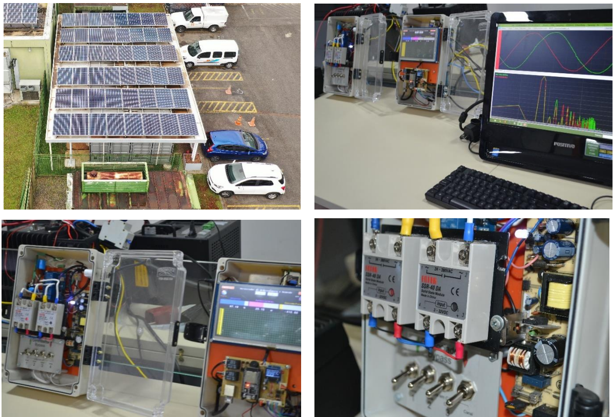
FIGURA 33 – MONTAGEM DO SISTEMA GERALDO NO COPELAB – COPEL DISTRIBUIDORA
