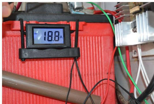
Figura 31 – MEDIÇÃO DE CORRENTE NAS BATERIAS
