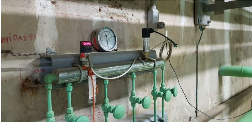
FIGURA 30 - MEDIÇÃO DA PRESSÃO NA SAÍDA DA TURBINA
