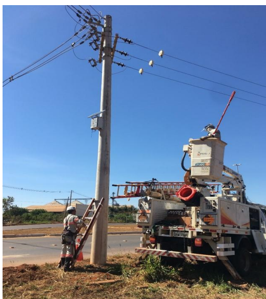
Figura 9 – Monitores de Falta instalados na rede de distribuição aérea
