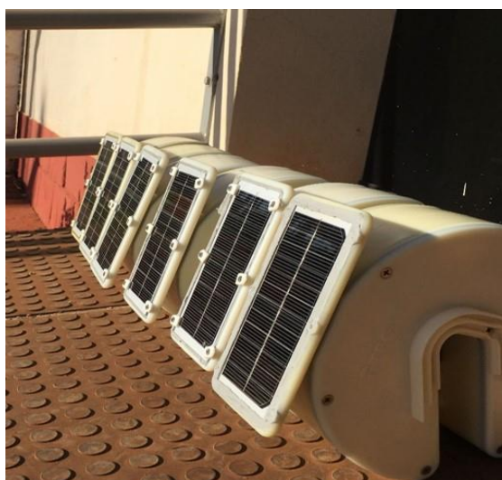
Figura 10 – Monitor de Falta com Painel Fotovoltaico
