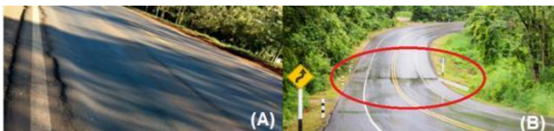
Figura 64 – Pista (A) com afundamento e (B) empossamento antes da curva Fonte: Adaptado de Kunzler (2018)
