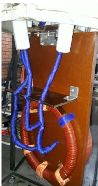
FIGURA 42 – TC TOROIDAL MONTAGEM EM ESTRUTURA E TANQUE METÁLICO
