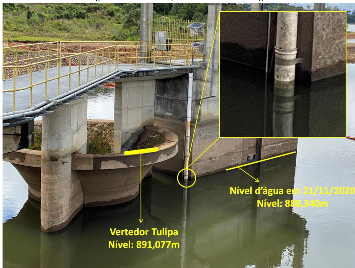
Figura 18: Vertedor tulipa e Sensor de nível d'água
