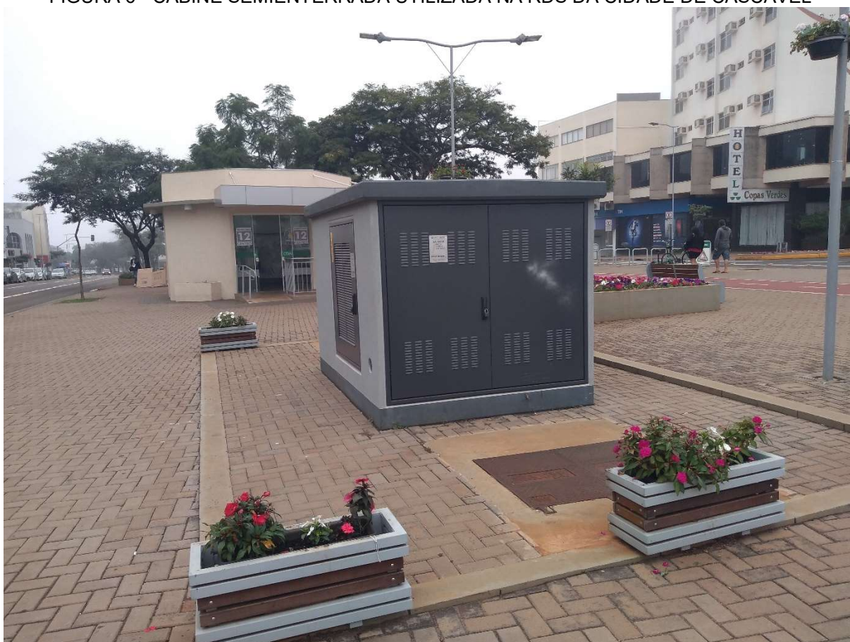
FIGURA 6 - CABINE SEMIENTERRADA UTILIZADA NA RDS DA CIDADE DE CASCAVEL
