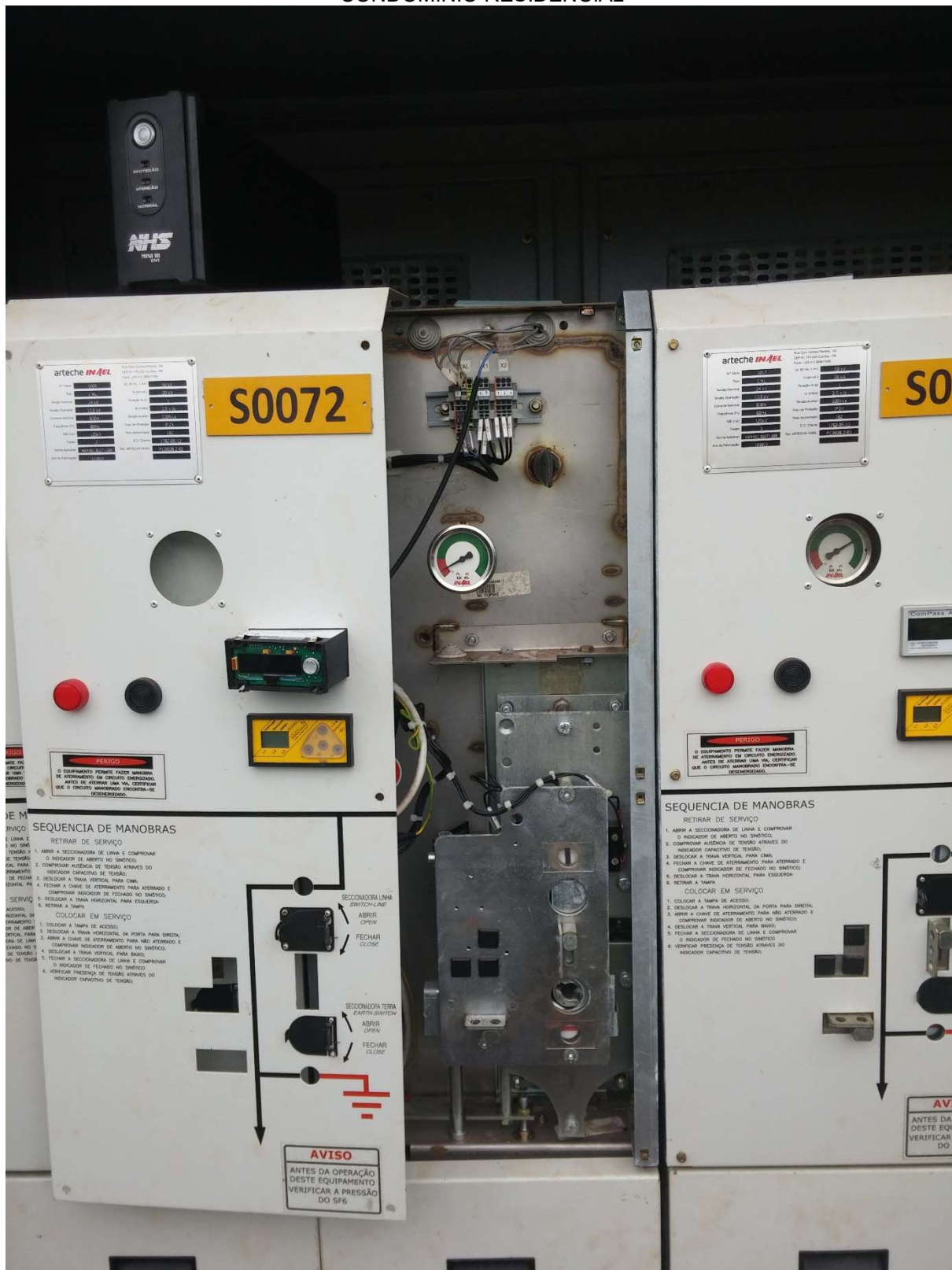
FIGURA 11 – EXEMPLO DE CUBÍCULO DE PROTEÇÃO E MANOBRAS INSTALADOS EM CONDOMÍNIO RESIDENCIAL
