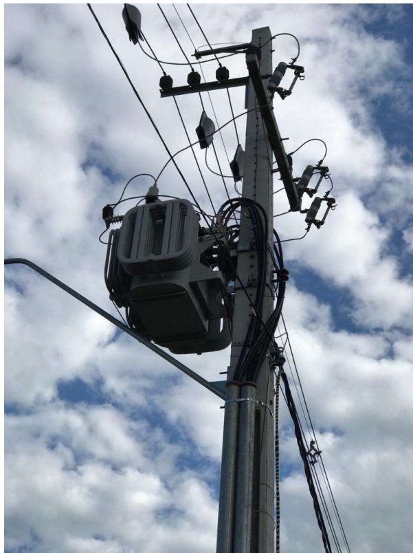
FIGURA 14 – TRANSFORMADOR INSTALADO EM POSTE
