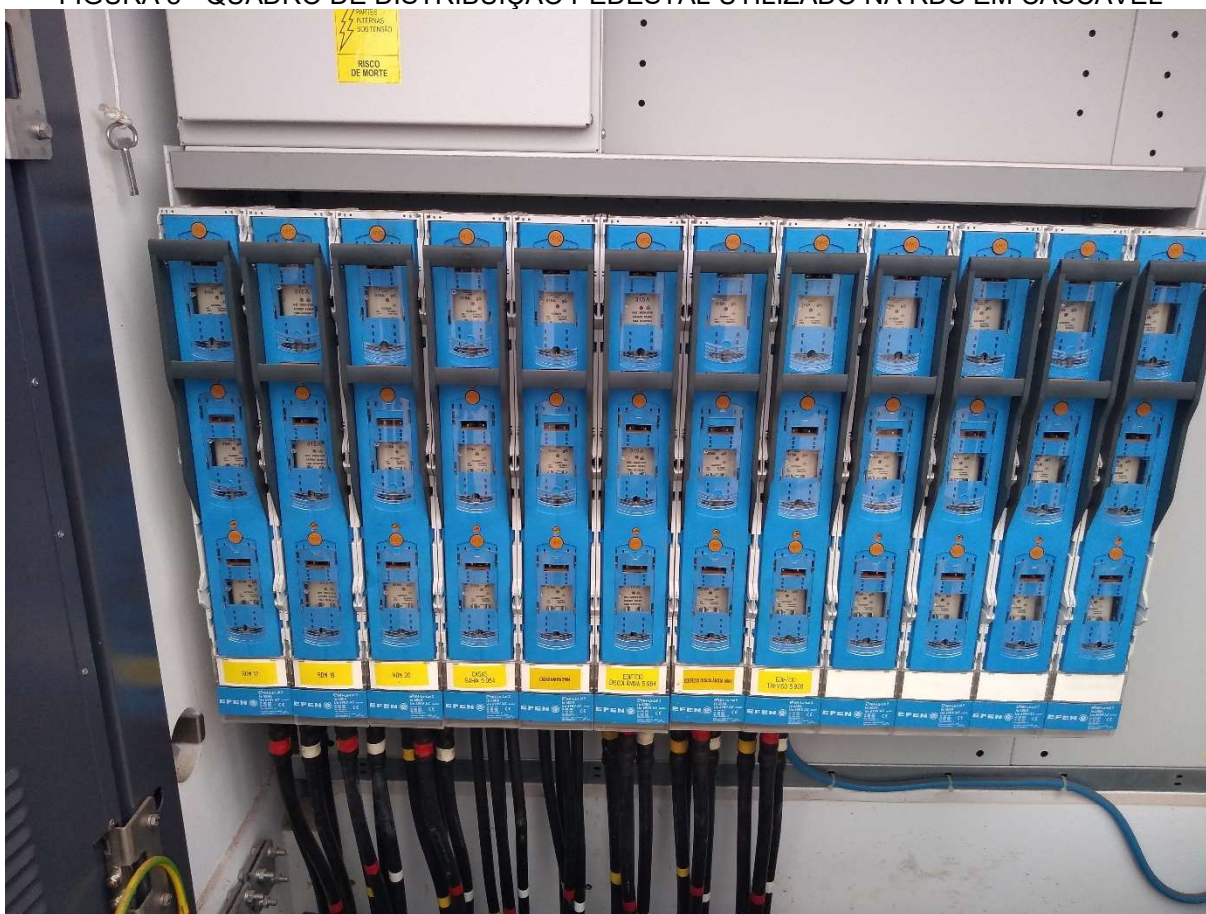
FIGURA 8 - QUADRO DE DISTRIBUIÇÃO PEDESTAL UTILIZADO NA RDS EM CASCAVEL
